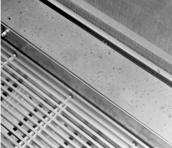
Abb. 1: Fensterrahmen aus glasperlgestrahltem nicht rostendem Stahl 1.4401 in einem Hallenbad; es sind viele braune Flecken sichtbar und die Metalloberfläche wurde durch Lochkorrosion angegriffen
